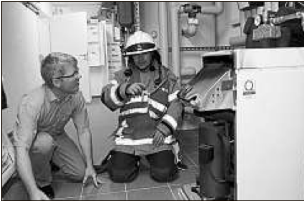
Der Firmeninhaber und der Neubulacher Gruppenführer begutachten den entstandenen Schaden.
