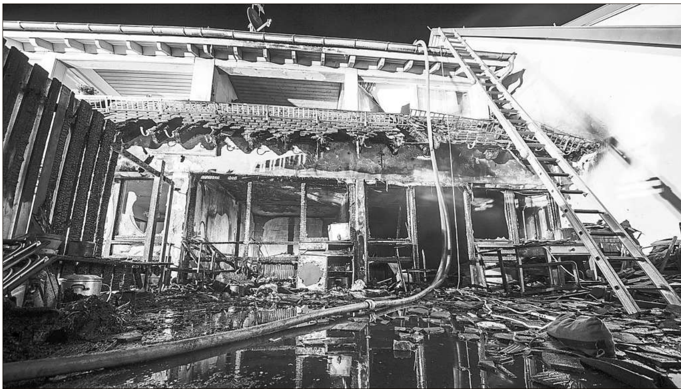
Stark verwüstet ist nach einem Brand eine Wohnung eines Mehrfamilienhauses in Neubulach.
